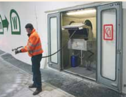
Vorhandene Löschvorrichtungen in den Pannebuchten verwenden!
